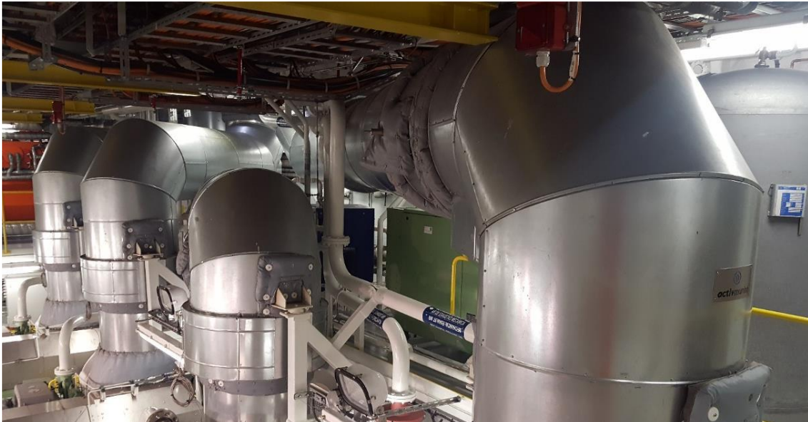
Figura 26: Linha de exaustão completamente vedada em conexões entre seções e curvas, sem possibilidade de ingresso de óleo diesel/lubrificante.
