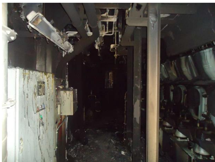
Figura 3: Sala de máquinas após incêndio devido a vazamento de combustível.
