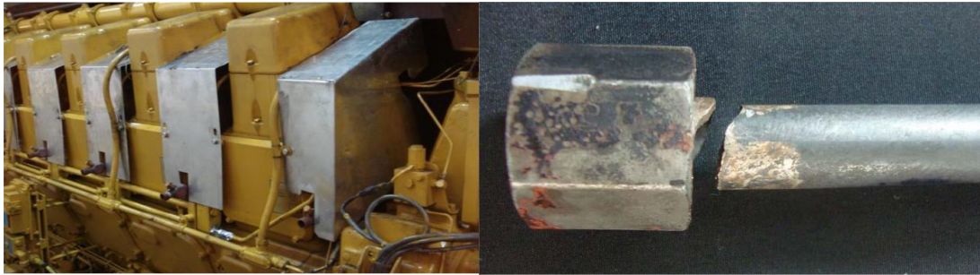
Figura 10: Proteção instalada para evitar spray por quebra em tubulação de diesel.
