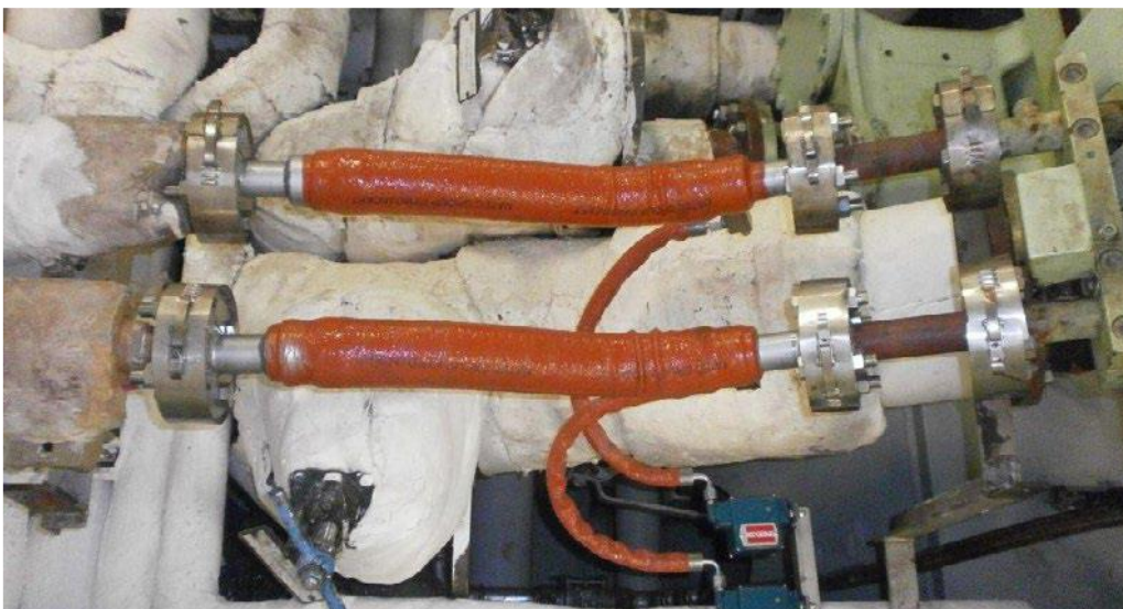
Figura 8: Aplicação de mangueira de combustível em sala de máquina.
