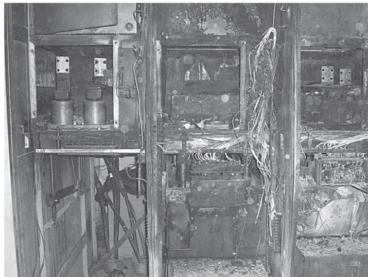
Figura 4: Painel elétrico após curto circuito.
