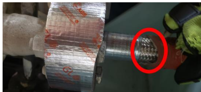
Figura 17: Verificação de integridade das proteções de mangueiras.
