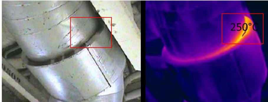
Figura 21: Exemplo de inspeção termográfica que não atende ao requisito SOLAS, com temperatura acima de 220°C em flange da linha de exaustão, com ponto quente na interface de transição entre isolamento térmico.
