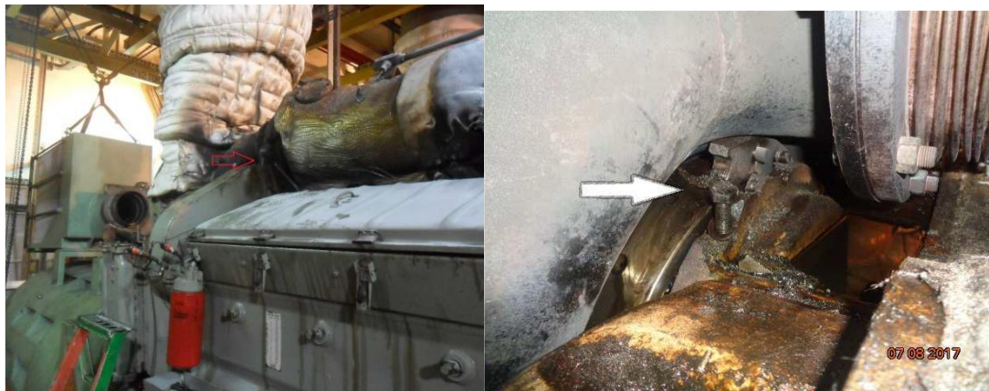
Figura 30: Local e parte da turbina danificada levando ao princípio de incêndio.
