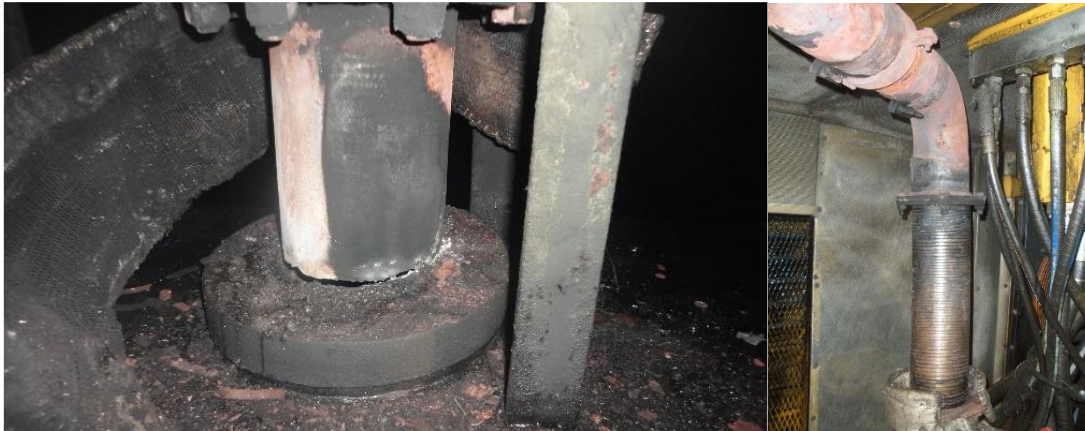
Figura 28: Linha de exaustão acima do piso acima da sala de máquinas do guindaste e linha de exaustão do motor no compartimento de máquinas do guindaste.
