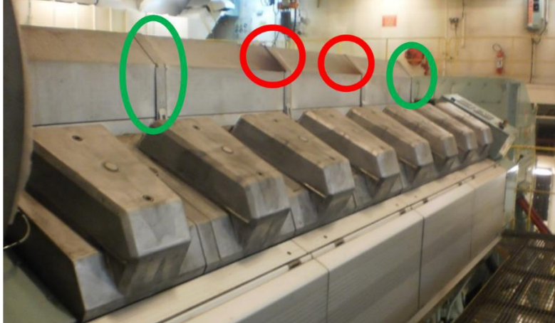
Figura 24: Destacado em vermelho manchas na proteção térmica do manifold de exaustão, com indícios de vazamento de ar de exaustão pelo manifold. Destacado em verde os pontos sem indícios de vazamento.
