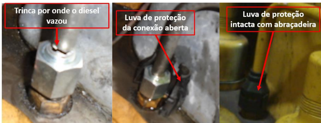
Figura 11: Luva de proteção em conexão de tubulação de óleo diesel instalada incorretamente gerando incêndio após quebra de conexão.
