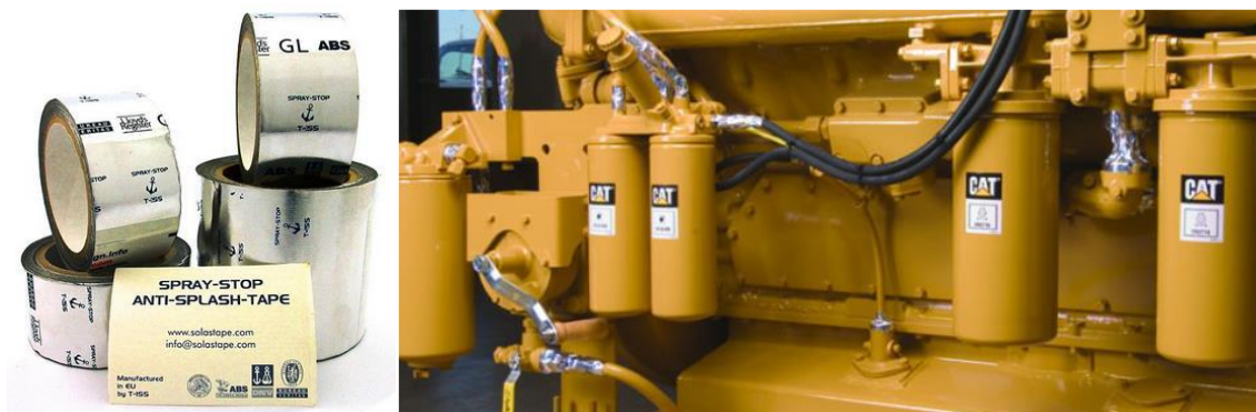
Figura 15: Fita anti-spray adequadamente instalada em conexões pressurizadas dos motogeradores.
