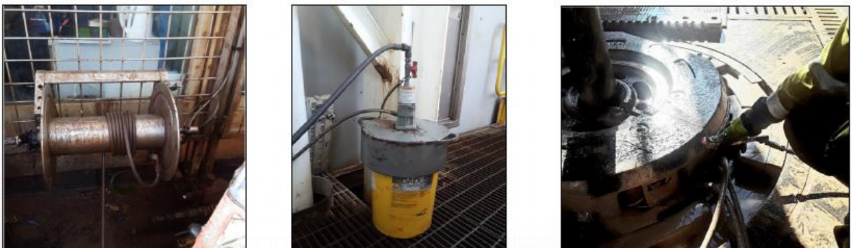
Figura 11 - Sistema de lubrificação automática
